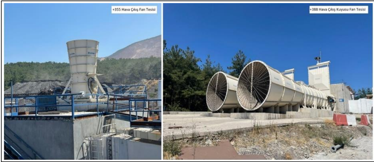
Şekil 3. +355 ve +388 hava çıkış galerilerinde kullanılan emici vantilatörler.
