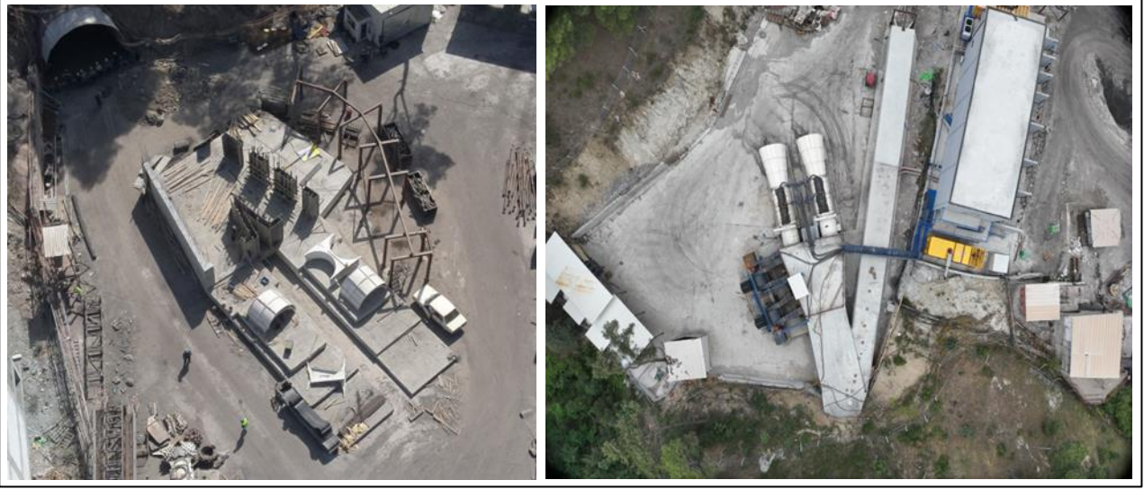
Şekil 5. +395 desandre çıkış ağzı ve fan tesisi.
